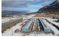
Canal Flats | 30MW
